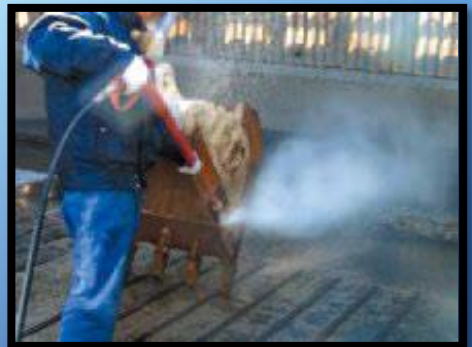
コンクリートの剥離
